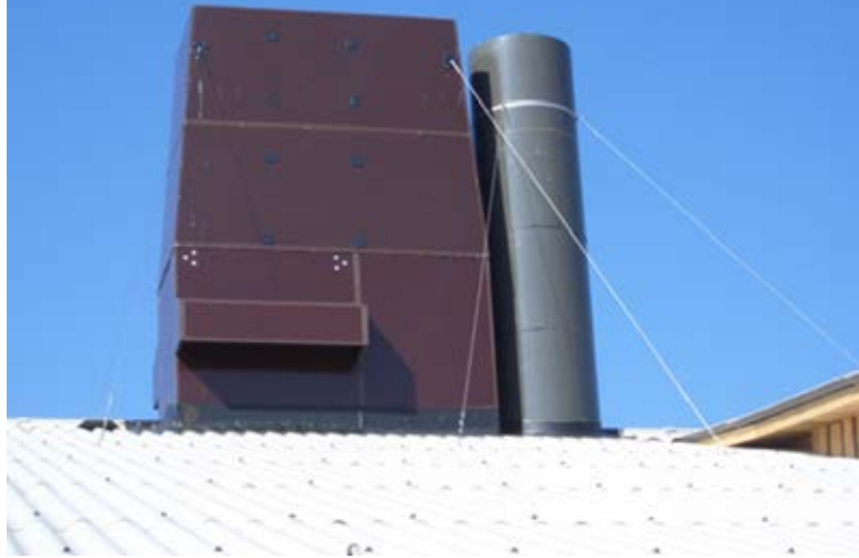
Außenansicht Wärmetauscher mit zusätzlichem Abluftkamin
