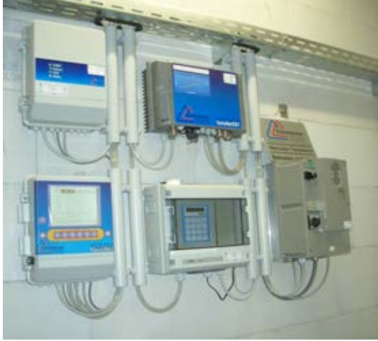
Lüftungssteuerung im Technikraum
